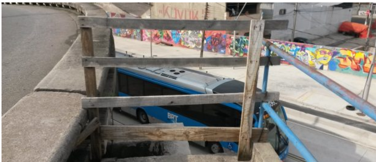
Passarela deixada pela metade após inauguração do BRT TransCarioca.
