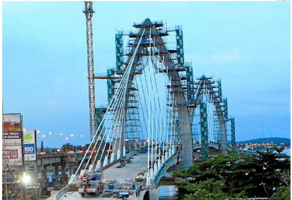
Mudança. A ponte estaiada que está sendo construída na Ilha do Governador: em vez de um mastro com 120 metros de altura, estrutura ganhou dois arcos de 60 metros
